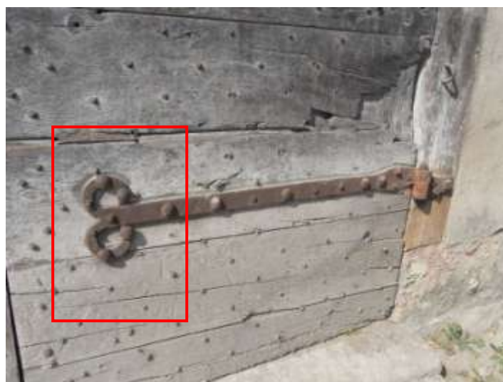
Gros plan sur ferrure d'origine réutilisée sur vantail de droite dont la position des clous de fixation correspond à ceux retrouvés inversés
